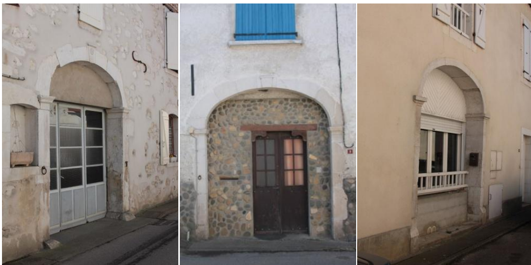
Le changement de destination de la grange peut entrainer des incohérence dans l'utilisation de l'ancien accès par le porche
