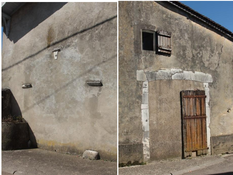
Vestiges d'anciennes ouvertures vers la grange
