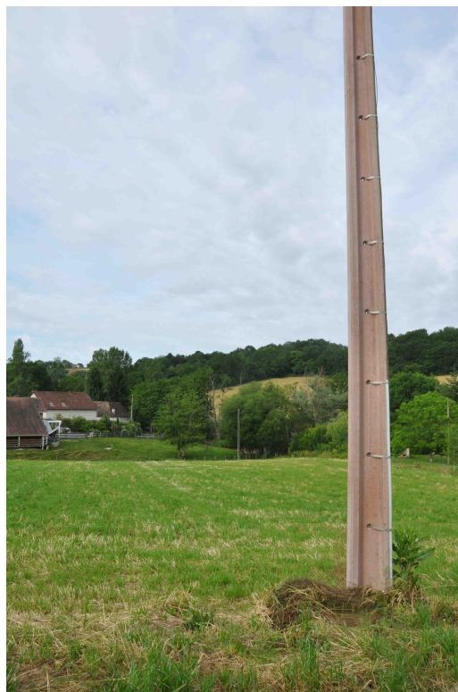
Poteau électrique n°2 installé au pied de la parcelle pour l'alimentation électrique des 2 lots.
